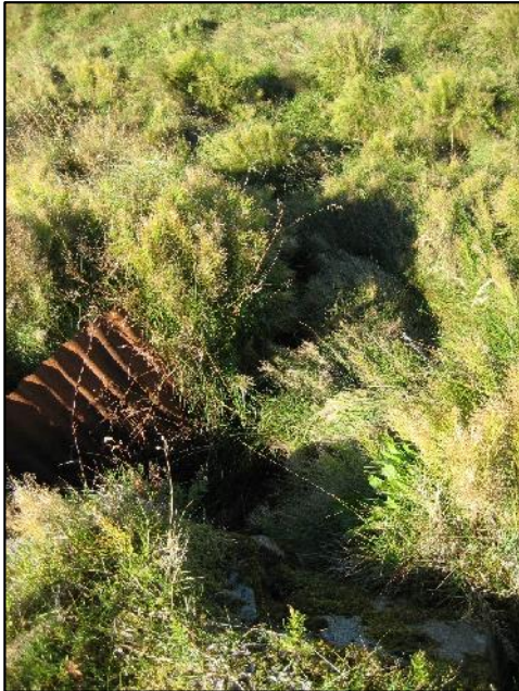
Dæld BO-142:035, horft til VSV
