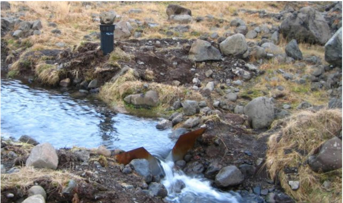
Mynd 11 Sambærilegt mæliyfirfall við það sem mælt er með að komið verði fyrir neðan fyllingastíflu. Á bakkanum fjær sést í mælibrunn.
