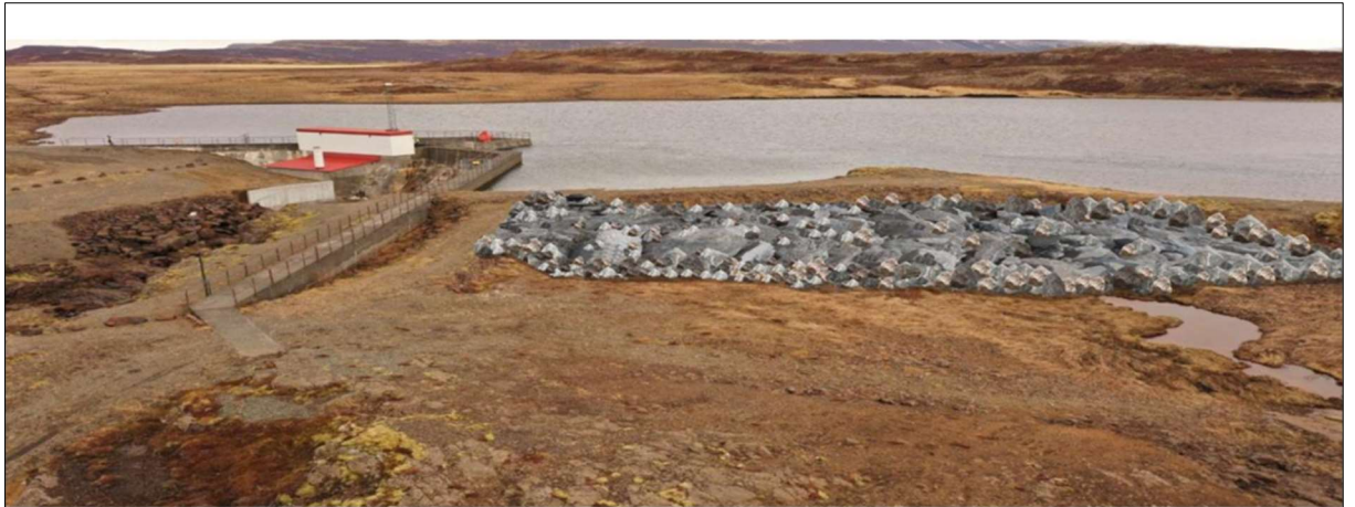
Mynd 5 Breytt ljósmynd af svæðinu fyrir tímabundna styrkingu á núverandi jarðvegsstíflu. Horft til norðausturs. Hægra megin á myndinni má sjá leka í gegnum stífluna.
